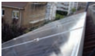
Foto 10. Paneles solares térmicos.
