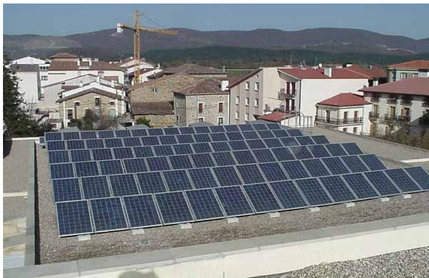
Foto 2. Instalación conectada a red.
