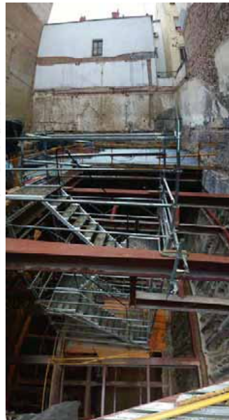
Figura 16. Construcción de un aparcamiento robotizado con 39 plazas bajo el patio de un edificio protegido en la C/ Santa Isabel, 21 (Madrid).
