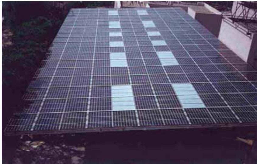
Foto 9. Instalación fotovoltaica integrada en cubierta.
