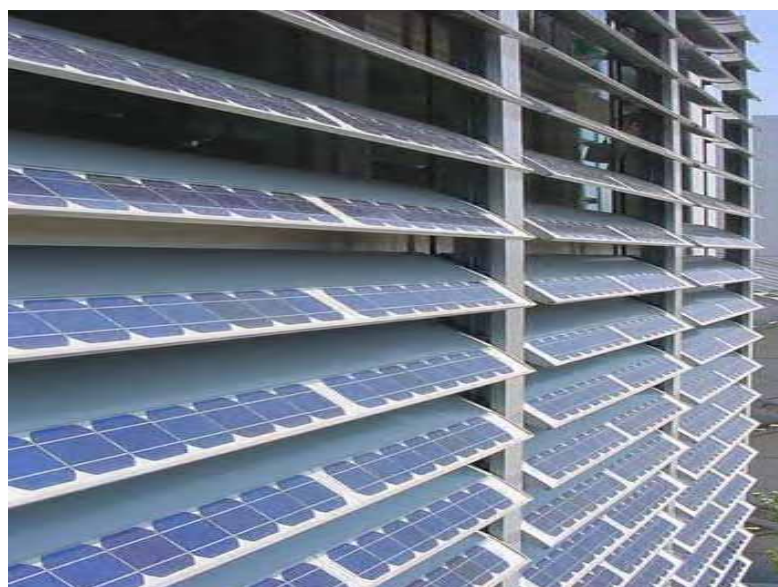
Foto 10. Instalación fotovoltaica integrada en lamas.
