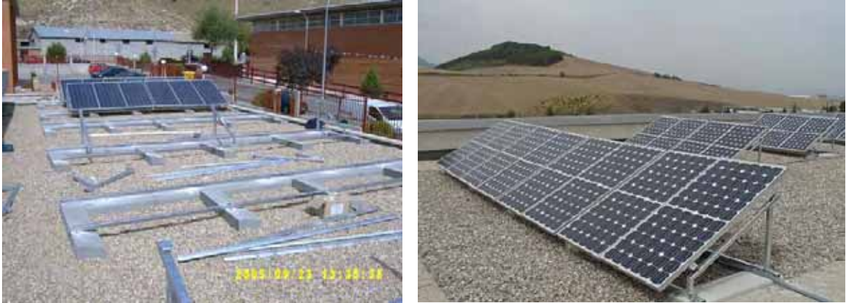
Foto 6. Sistema fotovoltaico sobre tejado plano no perforable.
