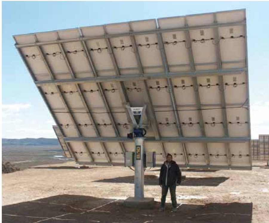
Foto 7. Instalación fotovoltaica sobre seguidor solar.
